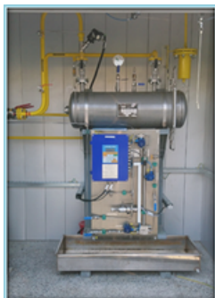
INSTALOVANÁ ODORIZAČNÍ STANICE OSGC ST1 V KOMBINACI S KONTAKTNÍM SYSTÉMEM -ILUSTRÁČNÍ FOTO-
